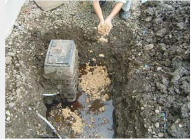
タンクからの灯油流出
