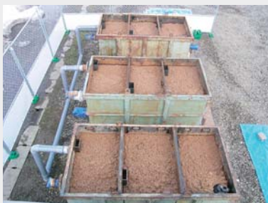
灯油流出事故現場油水分離槽
