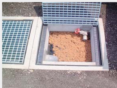
舗装プラント油水分離槽
